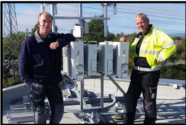
Frank og Birger fra Sønnico Tele bygger ut 4G på taket til Rema1000 Moholt!
